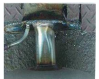
容器ネック部分の座屈(発災容器とは別)
